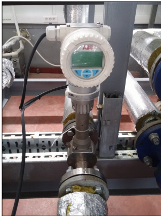
(d) Vortex flowmeter
