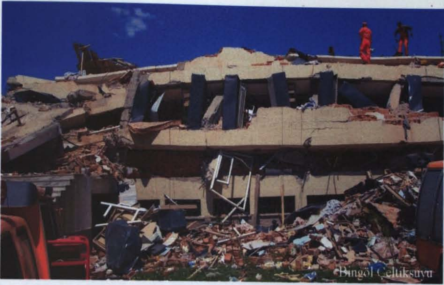
Photo 2.9 – Çeltiksuyu Yatılı Bölge Okulu after Bingöl earthquake
