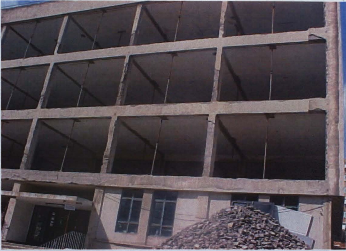
Photo D.7 – Insufficient structural design at Kadıköy Avni Akyol Güzel Sanatlar Lisesi
